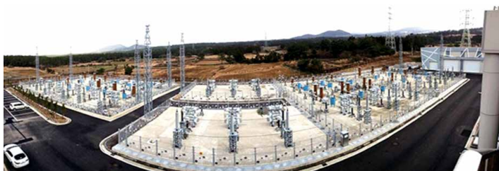
그림 5 제2 HVDC 제주변환소(Alstom)
