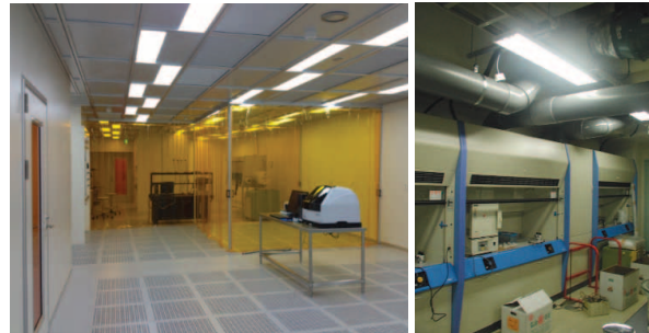
높은 층고의 층에 클린룸을 설치
